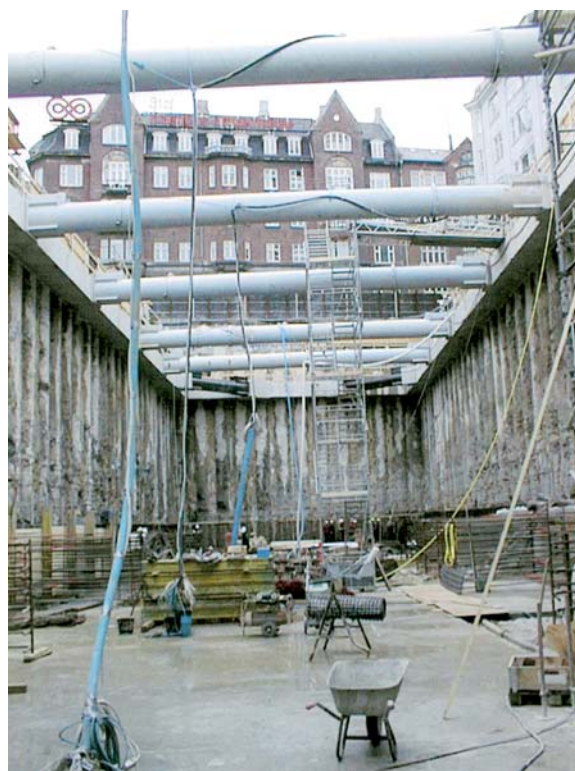
Figur 2. Konstruktionerna för de underjordiska Metrostationerna i centrala Köpenhamn baserades på ENV 1997-1 (1994). Här schakt för station Christianshavn.
